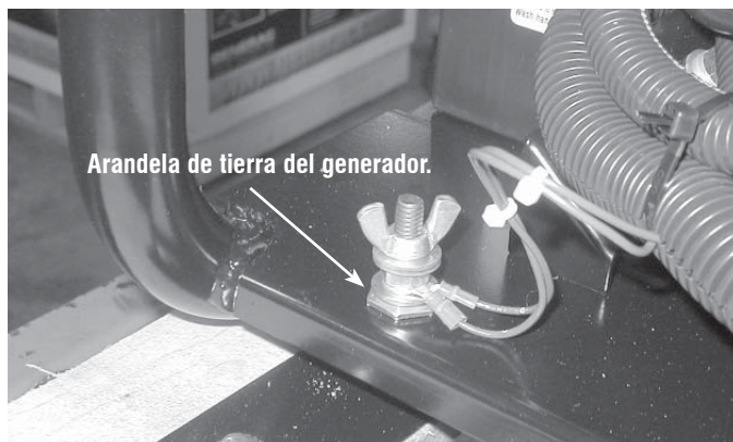
Figura 15 - Conexión a tierra del generador
