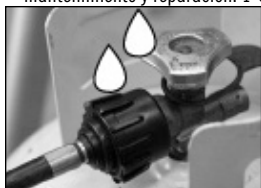
Fuga Regulador y manguera
